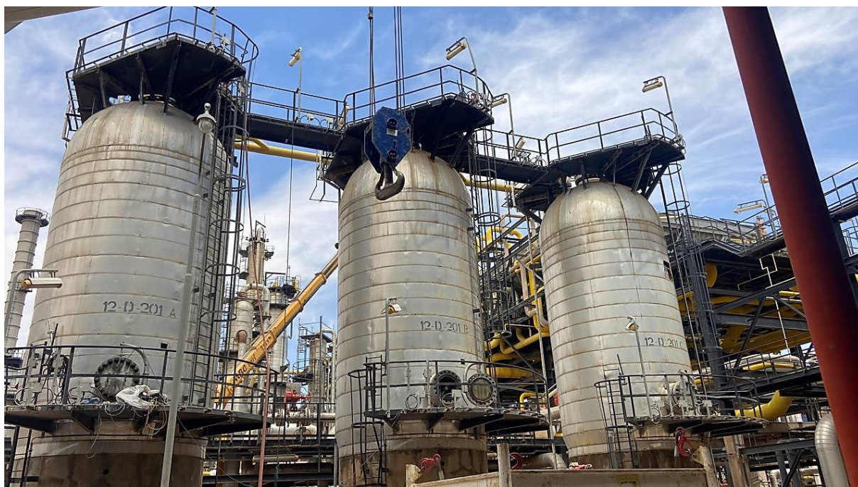
Figure II .4 : Les trois déshydrateurs de l'unité GPL2.
