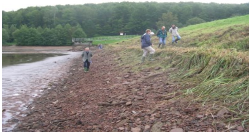
Figure 2.34 : Vue des dégradations du talus amont pendant la vidange du talus amont (géométrie irrégulière) rip-rap. [a]
