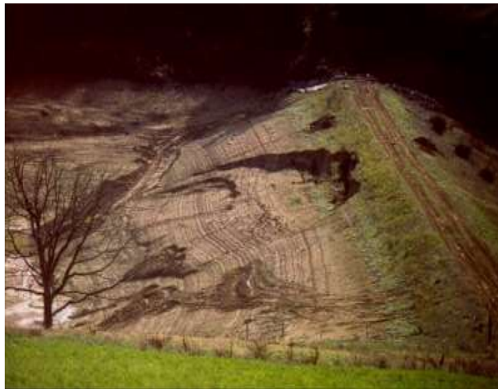
Figure 2.13 : Glissement de parement amont [4]
