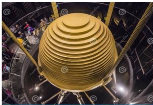
Figure IV. 16: Amortisseur de masse de la tour de Taïpeh 101 [37].
