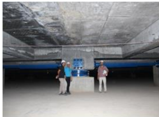
Figure IV.14 : Système d'isolation à la base de la grande mosquée d'Alger [34].
