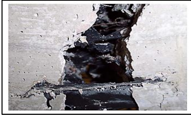
Figure IV.34: Détails d'une section fissurée pour une poutre caoutchoutée. [92]
