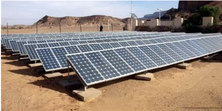
Figure (I.10) : Un modèle des panneaux solaires installé dans le sud
