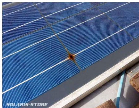
Figure 2.3 : Défaut point chaud
