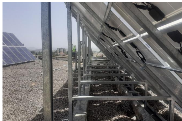
Figure IV. 3: Les panneaux solaires
