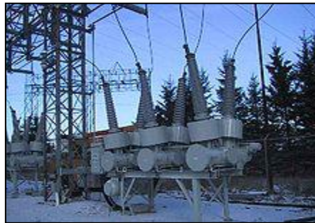
Figure II.7 : Disjoncteur 115 kV au Canada
