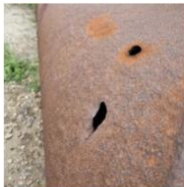
Figure I.3: Conduite en corrosion par piqûres
