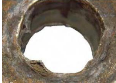
Figure I.4: Conduite en acier inoxydable en corrosion caverneuse.
