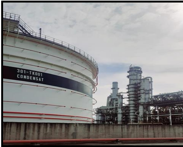
Figure II.1 : Unité de Topping de condensât - RA2K.
