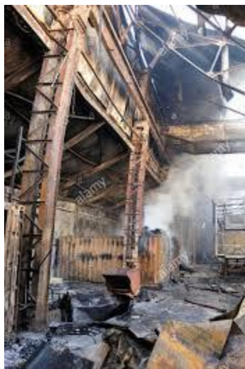
Figure I.4: Incendie d'une usine en acier tordu et fondue.
