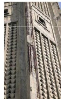
c) éclatement généralisé
