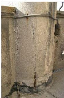
a) taches de rouille+ fissuration
