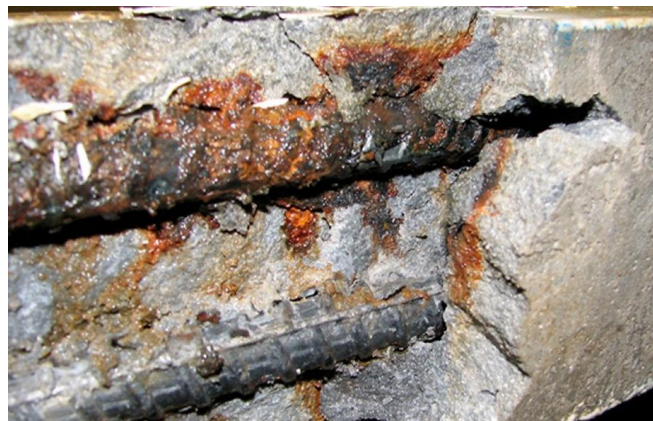
Figure I.16 : Corrosion des armatures dans le béton.
