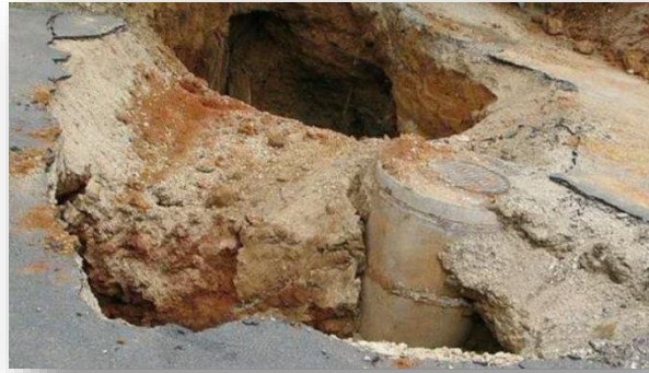
Figure I.20 Une route affaissée en Mayenne.
