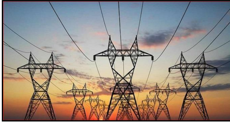
Figure I.1 : Les lignes haute tension [3].
