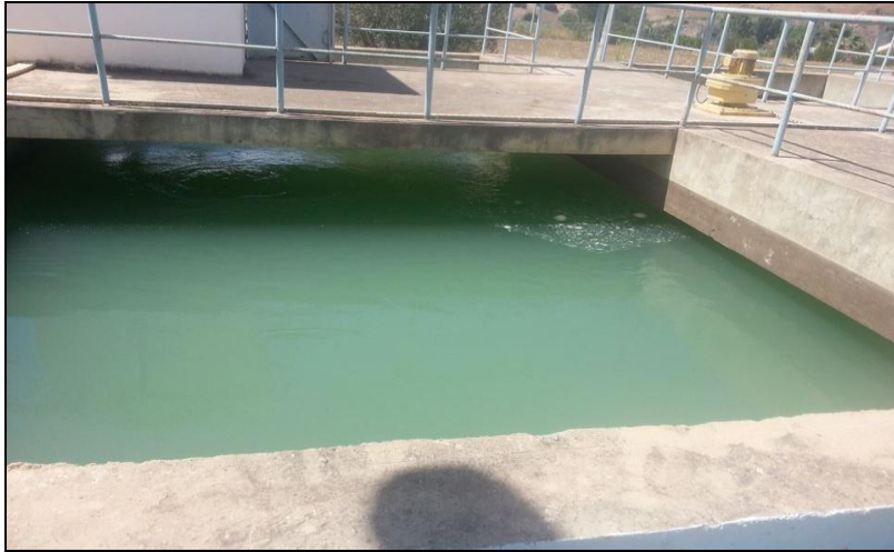
Figure 04 : Bassin de floculation (Cliché Bouzidi pris le 16/03/2017).
