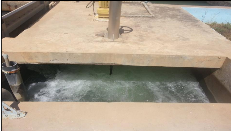
Figure 03 : Bassin de coagulation (Cliché de Bouzidi pris le 17 /03/2017).
