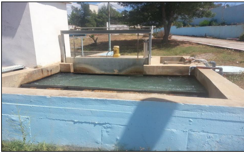
Figure 02 : Bassin du pré chloration (Cliché de Bouzidi pris le 17 /03/2017).
