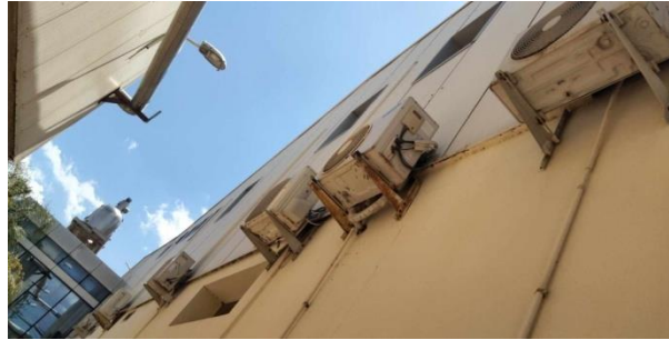
الصورة 03: وجود نظام تهوية مركزي في بعض أماكن العمل
