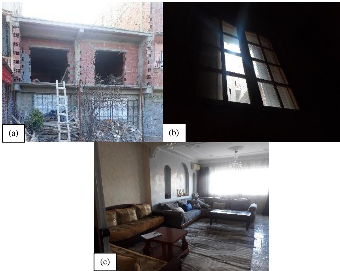
Figure VII-7. a) Agrandissement des fenêtres dans le 1 er étage en cours. b) Agrandissement des fenêtres au niveau de la cage d'escalier. c) Agrandissement des fenêtres au niveau de l'extension horizontale (Source : Auteur, 2020)
