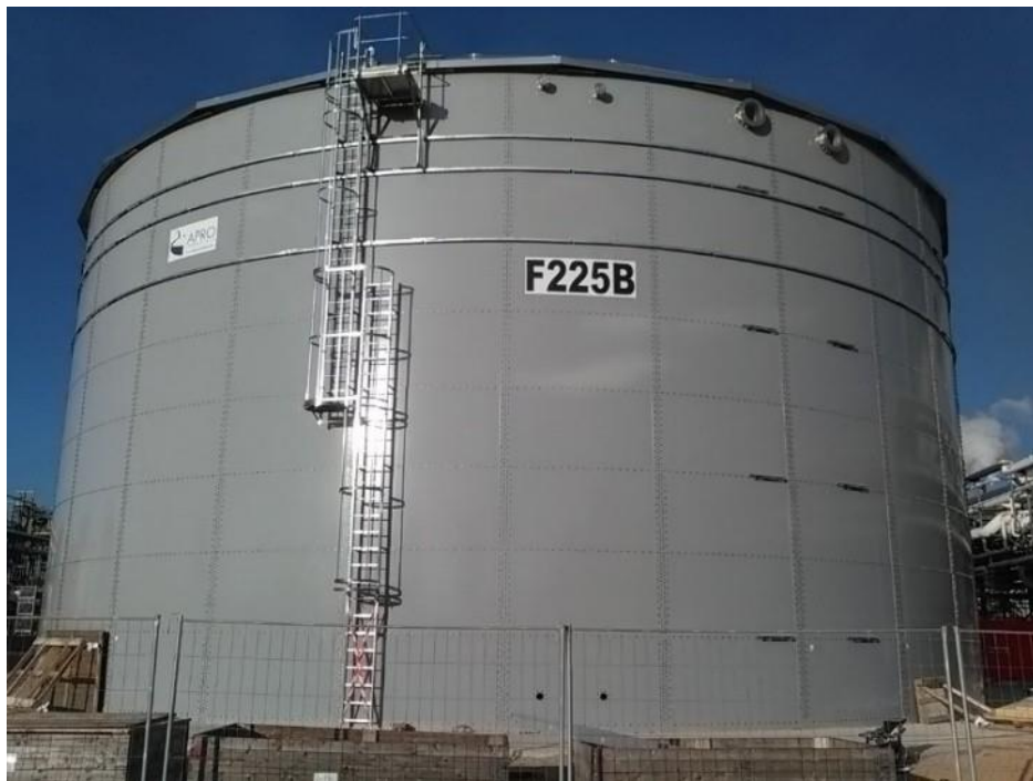
Figure III.8 : Réservoir pour stockage d'eau potable.
