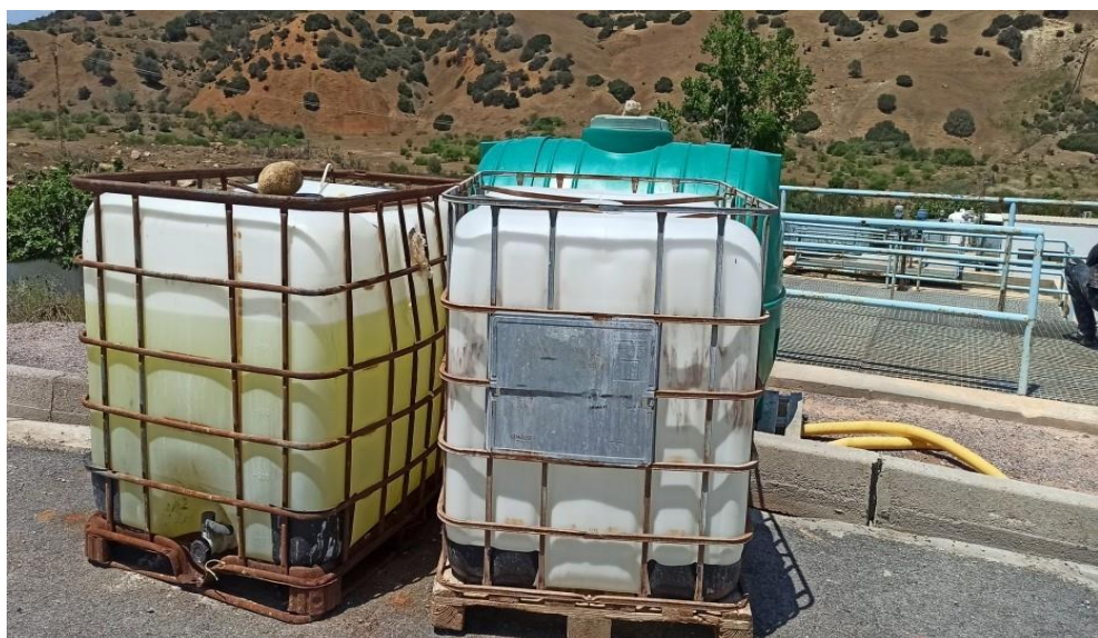
Figure IV.4 : Réservoirs du chlore.
