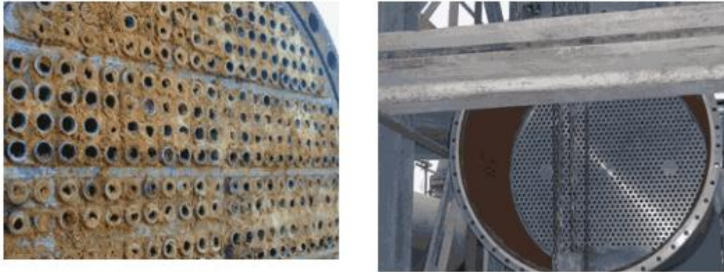
Figure II.10 : Echangeur propre et échangeur encrassé.
