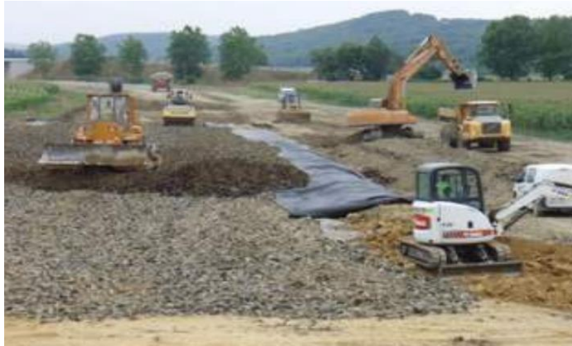
Figure II.14 Vue générale du chantier – la mise en œuvre des copeaux de pneus
