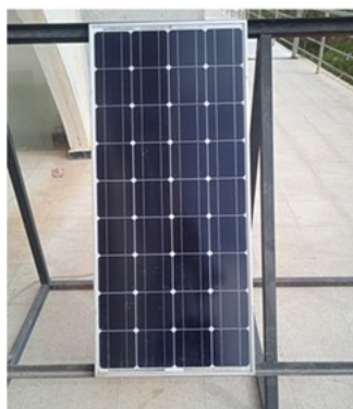
Figure.III.2: Capteur solaire photovoltaïque.
