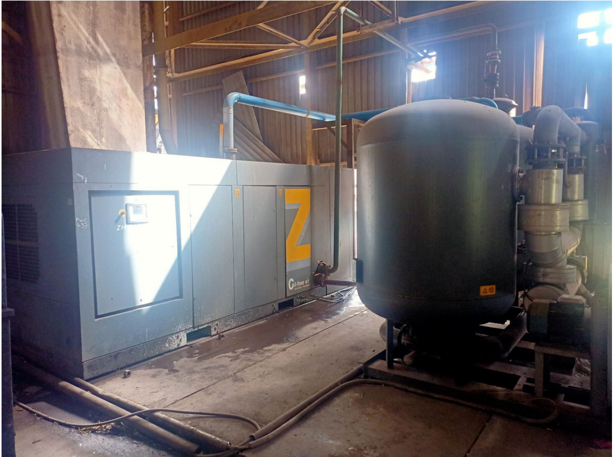
Figure II.3 : Le compresseur et sécheur du laminoir à chaud (LAC).
