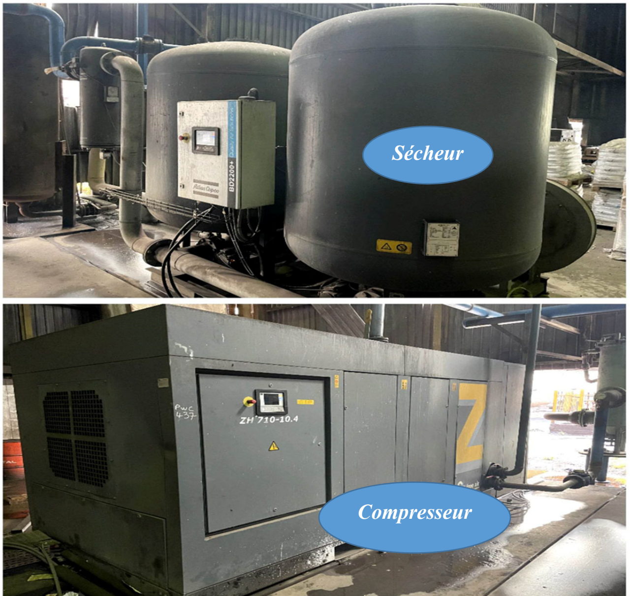
Figure I.4 : Unité de traitement d'air comprimé du laminoir à chaud.
