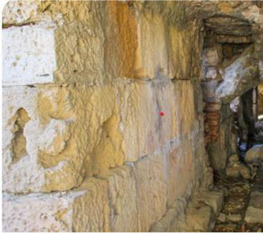
صورة رقم 10: تقنية البناء بالحجارة الكبيرة ،إحدى أروقة الخدمات بالحمامات الكبرى الشمالية (تصوير الطالبة)
