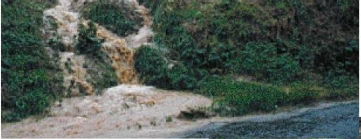
Figure 9.6. Dégâts sur les voiries occasionnées par les eaux de ruissellement fortement chargés en matières en suspension
