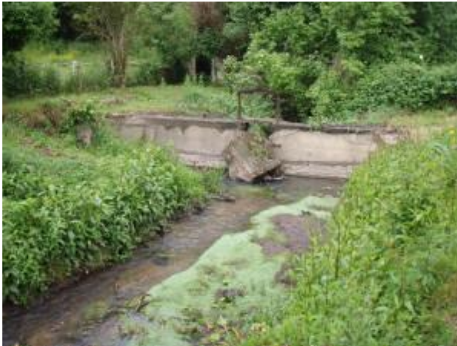
Figure 7.1. Abaissement des ouvrages
