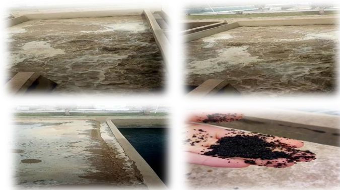
Fig.13. Bassins de Filtration
