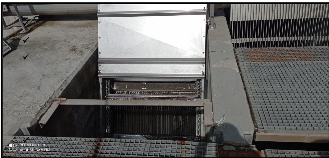
Figure 09 : Entrée de la STEP de Guelma (Dégrillage). ( Yassad & Haiahem, 2022 ).
