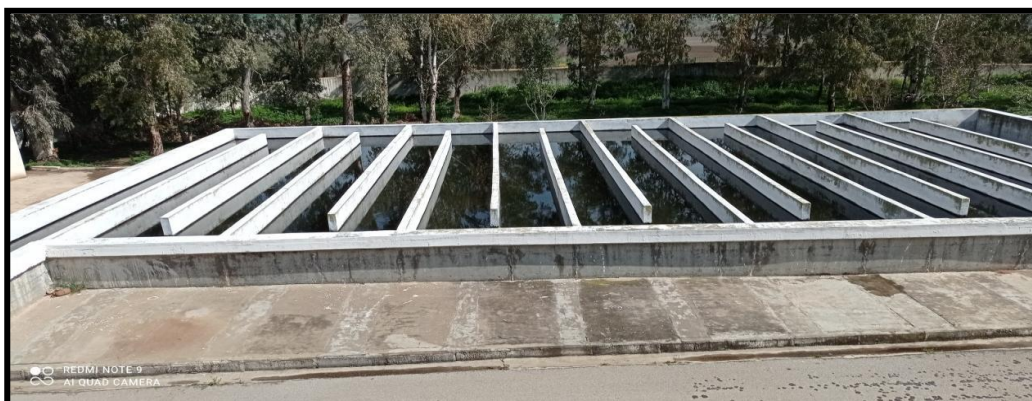
Figure 13 : Sortie de la STEP (bassin de désinfection). (Yassad & Haiahem, 2022).
