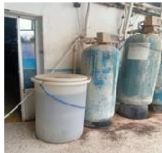
Figure 14. Filtre à sable et filtre à charbon (Djafri et al ; 2022).
