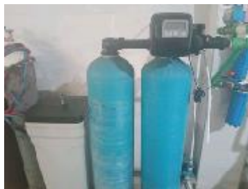
Figure46. Filtre à sable et filtre à charbon (Chemmakh et al ; 2022).
