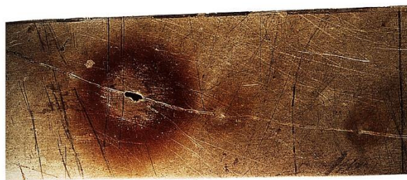
Figure I.4 : Corrosion par piqûres [13].
