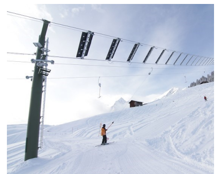
Figure 76: panneaux solaires posées sur câble téléphérique
