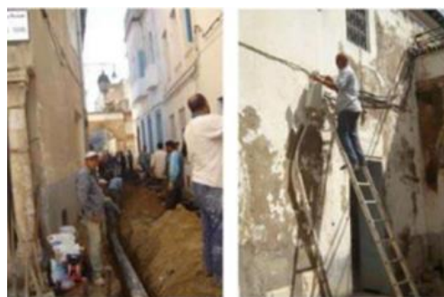
Figure 44 : Entretien des réseaux (câblage qui adhère l'esthétique des façades)
