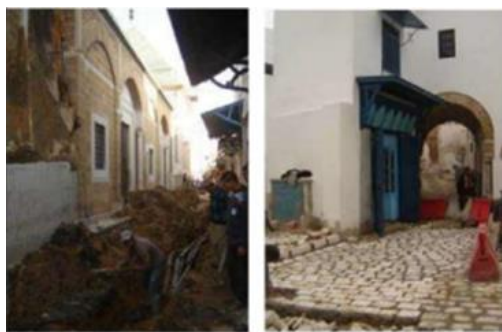
Figure 43 : Revêtement du sol ( pavage défectueux)
