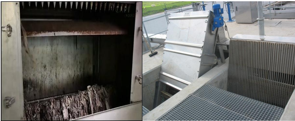
Figure 1-1: dégrilleur mécanique et manuel (Step Guelma)
