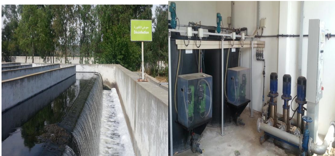
Figure 1-10 : Bassin de désinfection
