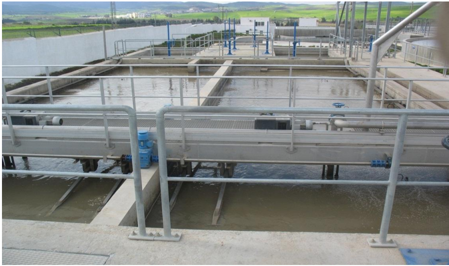
Figure 1-2 : Les deux bassins de dessablage/déshuilage (Step Guelma)
