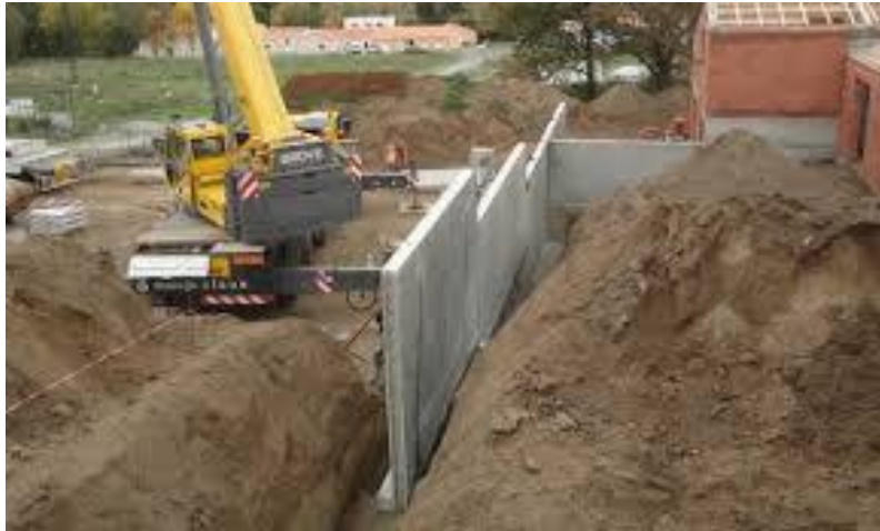
Figure I.10 : Murs en terre armée.
