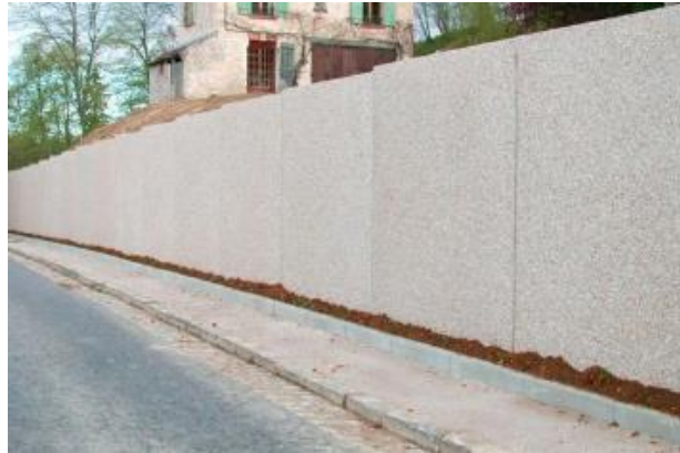
Figure I.4 : Mus en béton armé.
