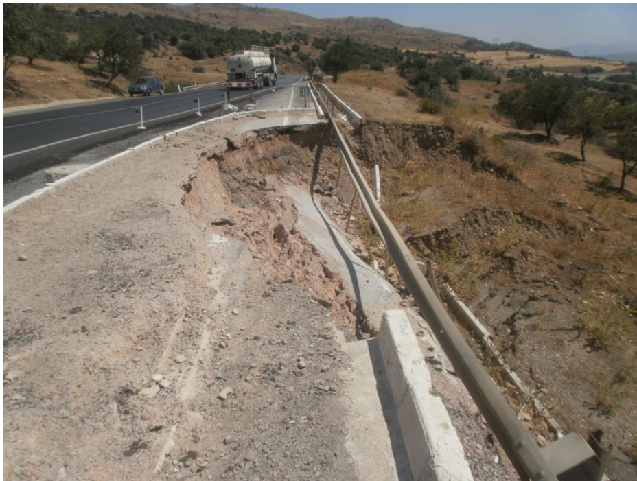
Figure IV.3 Décrochement vertical importante dans les remblais de quelques mètres en profondeur
