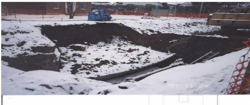
Figure I.23 : Affaissement du à l'instabilité de l'excavation.
