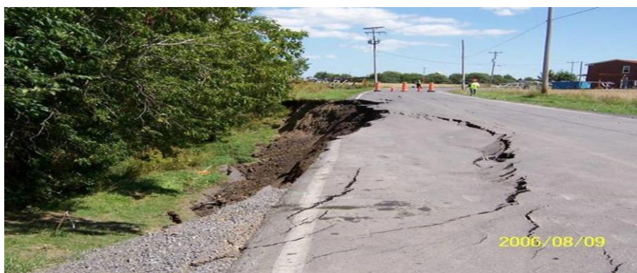
Figure I.22 : Affaissement de terrain.
