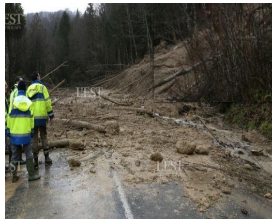
Figure III-4 : affouillement du pied de talus
