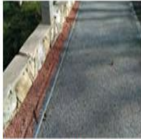
Béton poreux sur les trottoirs
