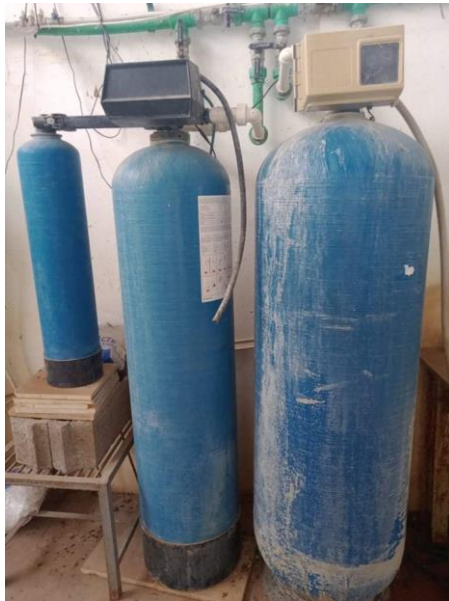
a. Filtre à sable
