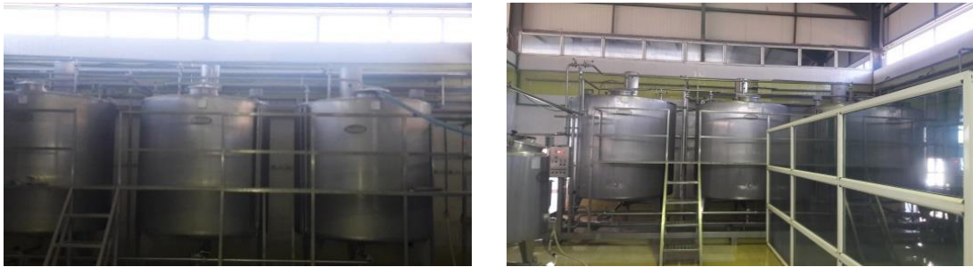
Figure 15. Les cuves de transformation du lait en poudre en lait de sachet
