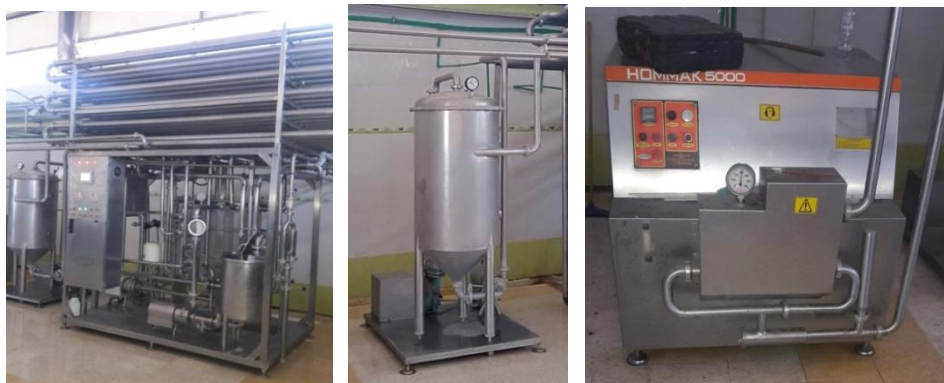
a. Un pasteurisateur. b. Un dégazeur c. Un homogénéisateur
