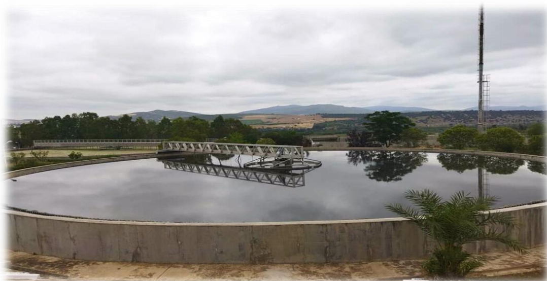
Figure. II.5.décanteur primaire (STEP Guelma 2021)
