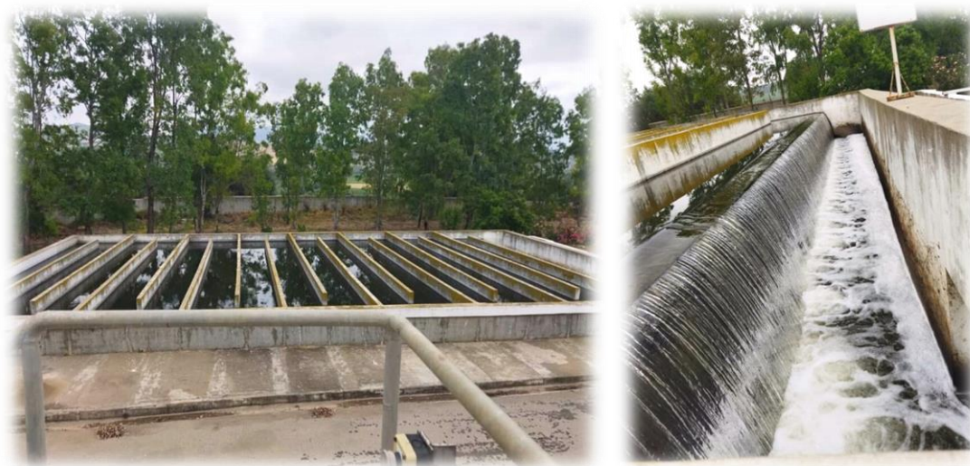
Figure. II.8. Bassin de désinfection (STEP Guelma 2021)
