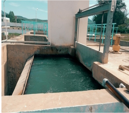
Figure I.III.2 : Bassin de pré-chloration.
