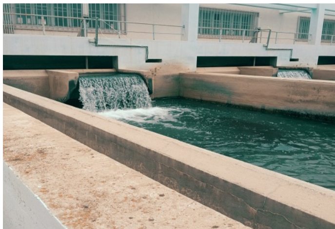
Figure I.III.7 : Bassin de filtration.
