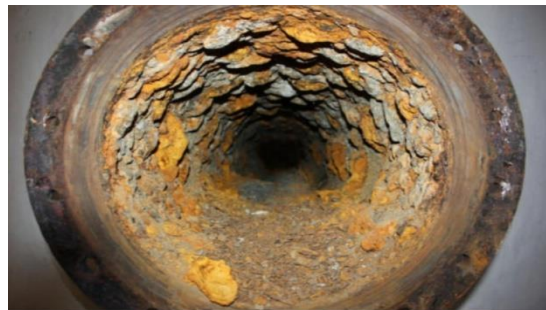
Figure I.8. La corrosion érosion [9]
