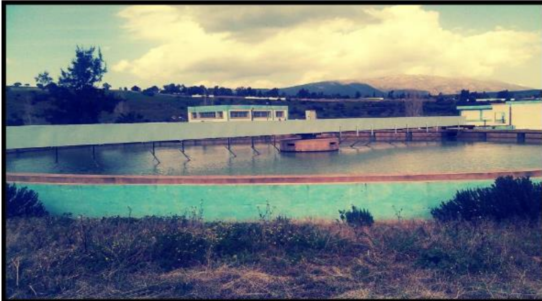
Figure 2.7 : Représente le bassin de décantation
