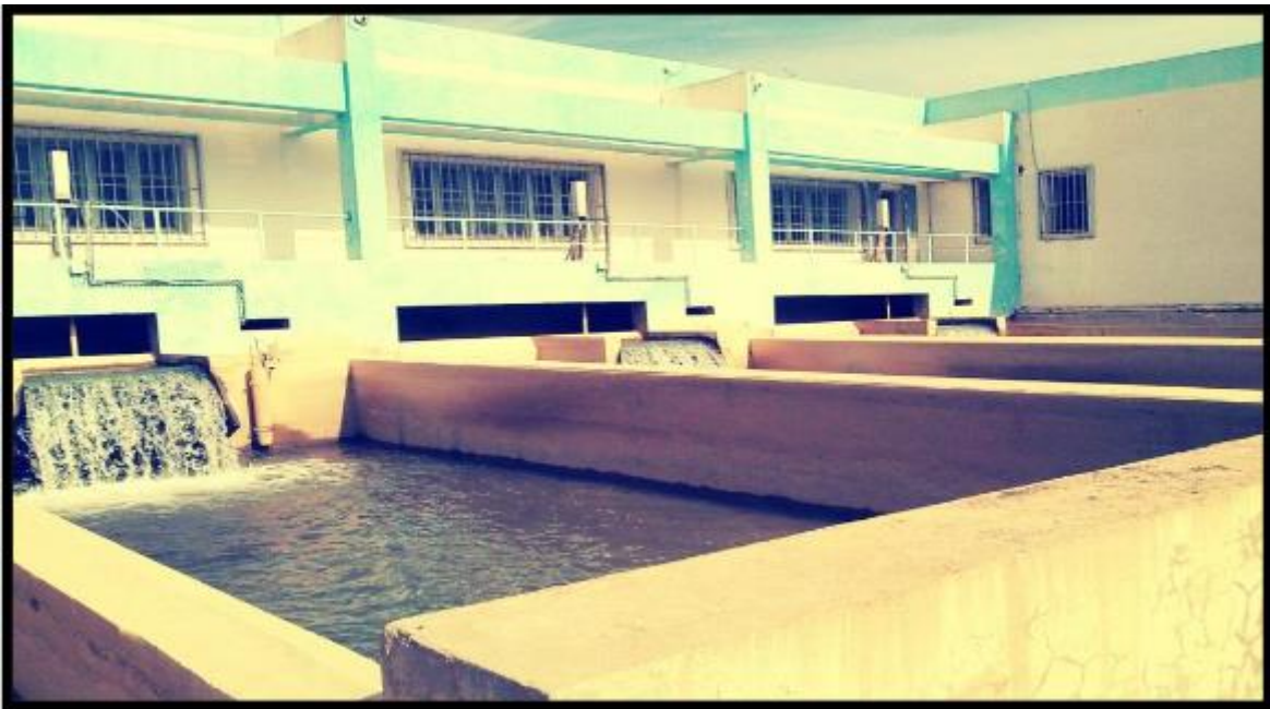
Figure 2.9 : Représente le bassin de Filtration
