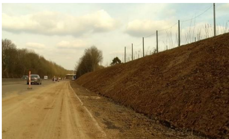
Figure II.6 Remblai qui permet de réduire la nuisance sonore provoquée par le passage des véhicules
