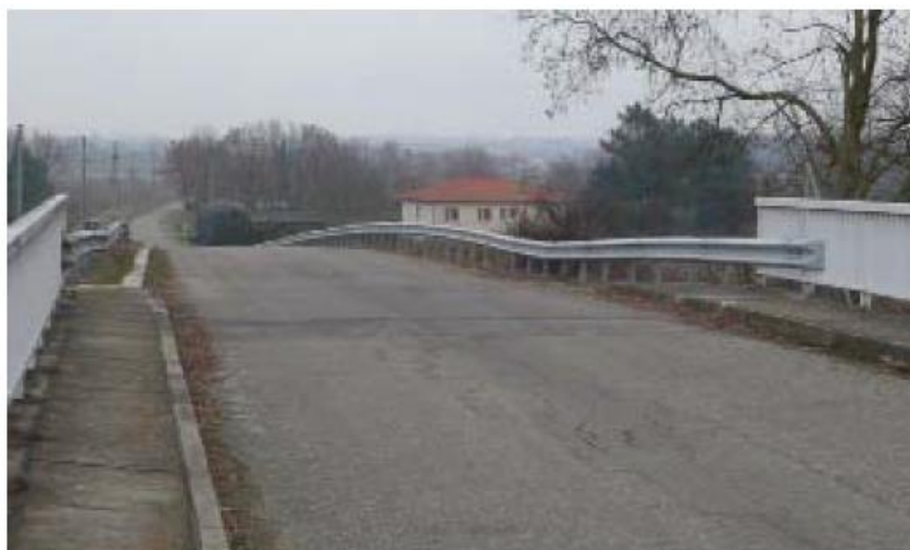
Figure II. 14 Affaissements d'un remblai contigu marqué par la déformation des barrières de sécurité
