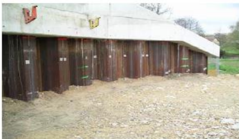
Figure. II.16 Remblai contigu en cours d'exécution. Les épaisseurs maximales des couches ont été notées à la peinture verte sur les palplanches métallique
