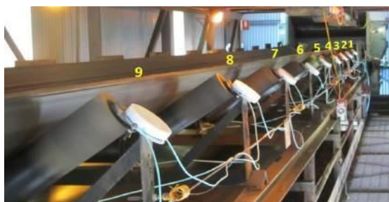
Figure III.10 Surveillance de température à base des fibres optiques.
