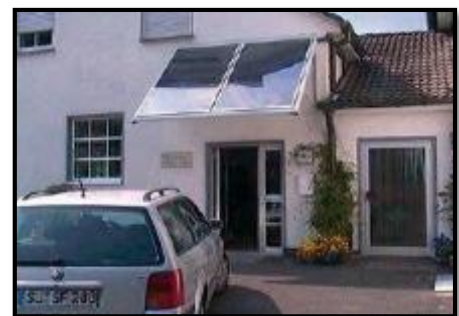
Figure 26 : Les capteurs solaires en décrochement de façade.
