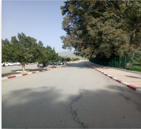
Figure 86 :la vois mécanique de complexe thermal
