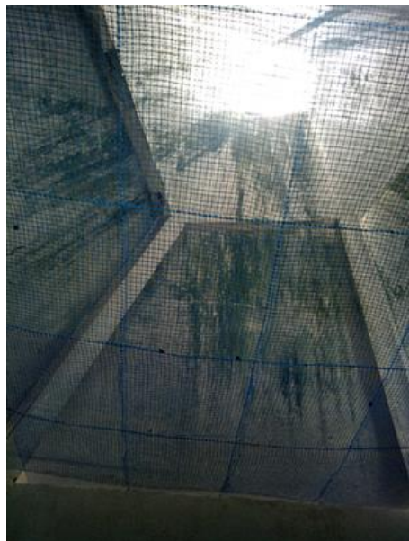
Figure 110 :l'intérieur de aération sous le piscine collectif
