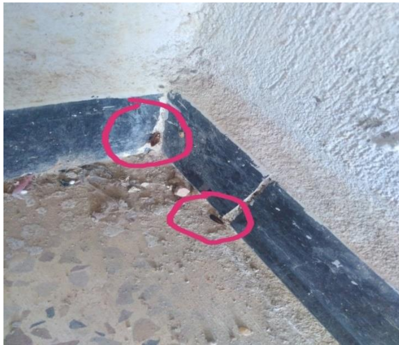
Figure 11. Lieu de collection de blattes dans les bâtiments (photo original, 2020).
