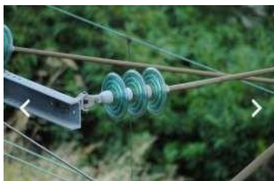
Figure I.7 : Isolateur en verre de ligne électrique.
