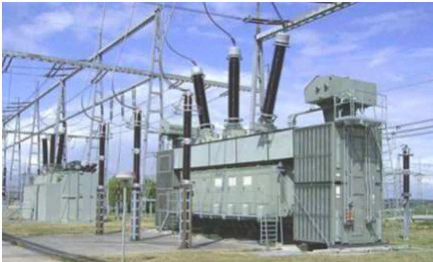
Figure I.7: Transformateur de puissance d'un poste électrique HT [4].
