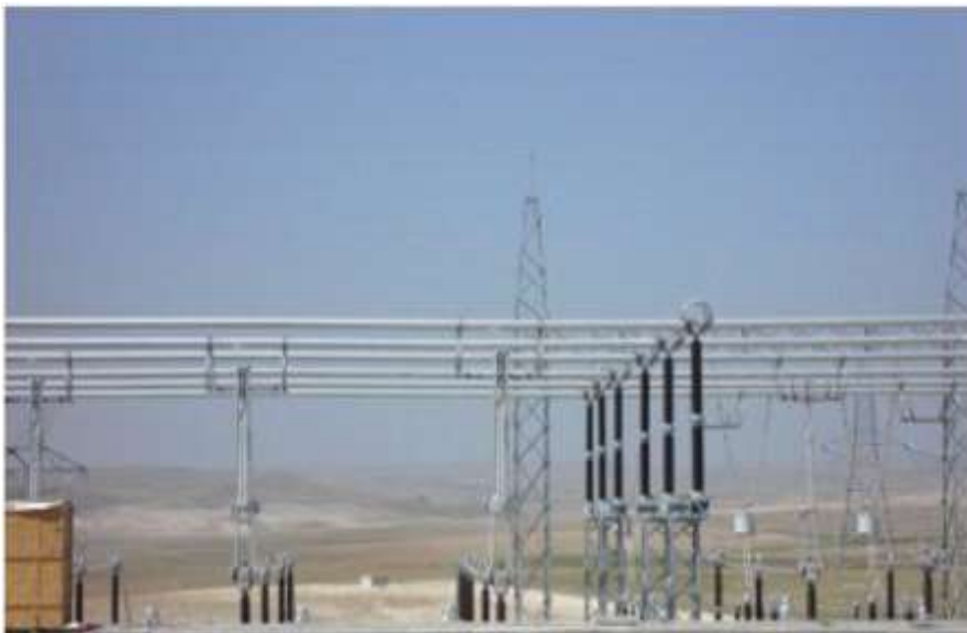
Figure I.3: Jeux de barres de poste 400 KV [4].
