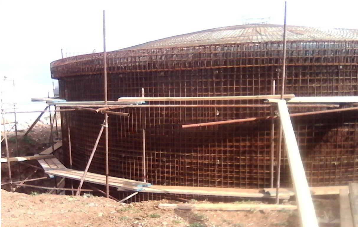
Figure X.4 : Exécution le ferrailage vertical et horizontal du fût cylindrique et la coupole y compris la ceinture supérieur (poutre dimension 40 \times 65 \text{cm}^2 )
