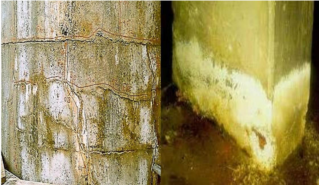
Photo II.1 : Poteau en béton dégradé par les attaques sulfatiques interne et externe [Net-1].
