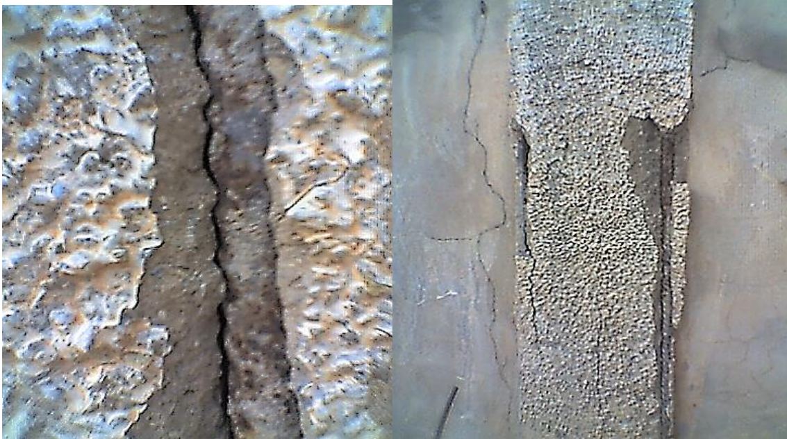
Photo II.4 : Poteau en béton armé dégradé par la corrosion [Bensafir 2010].
