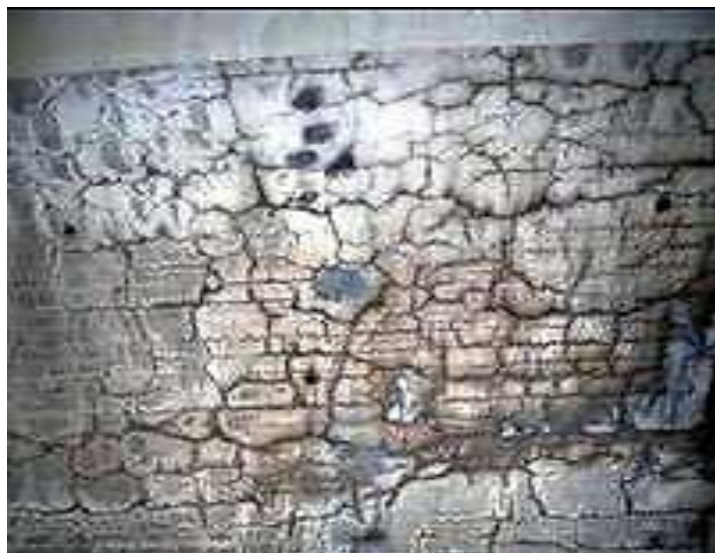
Photo II.2 : Mur en béton dégradé par la réaction alcali-granulat [Net-2].
