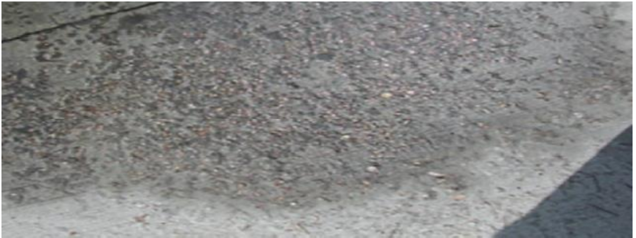
Photo II.7 : Dégradation due aux sels de déverglaçage [Itmaizeh 2016].
